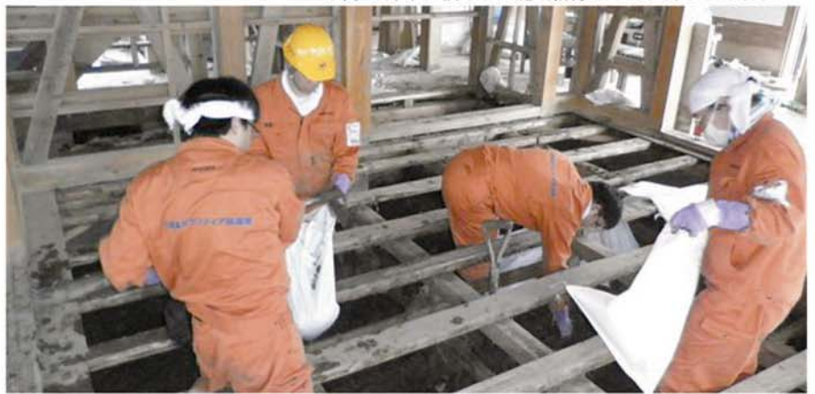
民家の床下に積もった泥を排除するのに汗びっしょり
