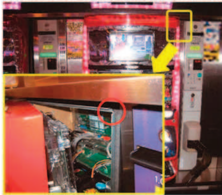
「マクロス」への被害が懸念される箇所
