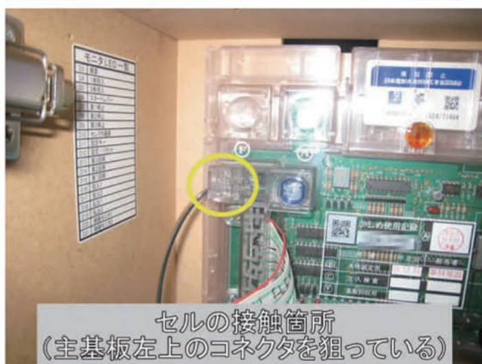
セルの挿入箇所(裏側) ○部分からセルが侵入してくる
