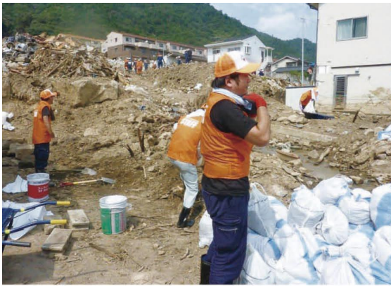
◀(上)土砂流が家屋を潰しながら流れ下ってきた傷跡 (下)土砂流に襲われた民家の敷地から瓦礫、汚泥を処理 (写真はすべて安佐南区八木地区)
