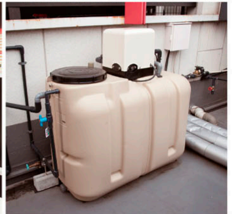
室外機を冷やすために水を貯めている散水システム
